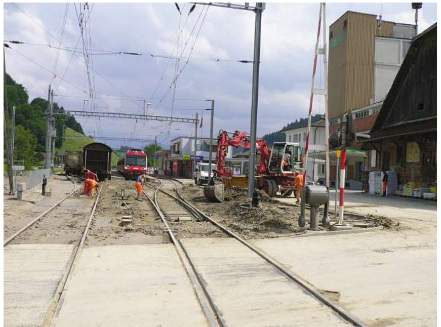
Aufräumarbeiten beim Bahnhof Menznau, 10. Juni 2007
