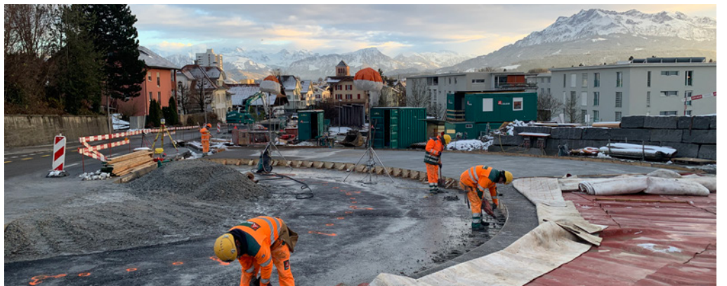
In der Gemeinde Rothenburg erstellen Bauarbeiter auf der Kantonsstrasse einen Kreisell – im Hintergrund der Pilatus. (Bild: BUWD)
