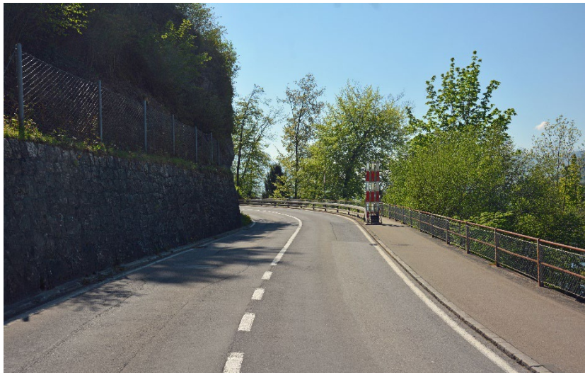
Foto 1: Blick Richtung «Ober Nas» mit sanierungsbedürftiger Stützmauer
