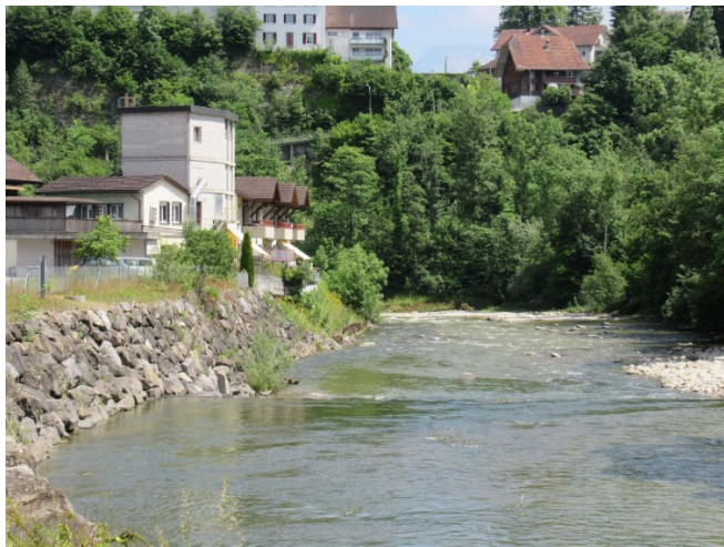
Abb. 1: Linksseitige Ufermauer mit Schutzdefizit
